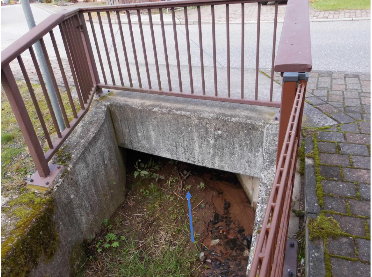
Abbildung: Woogbach, Durchlass Hauptstraße Einlauf b/h= 2,00/0,70m
