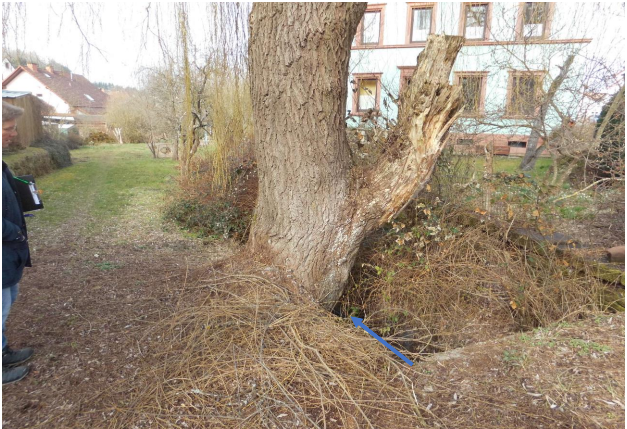
Abbildung: Eine Weide im Auslaufbereich der Rohrleitung (DN 1000)
