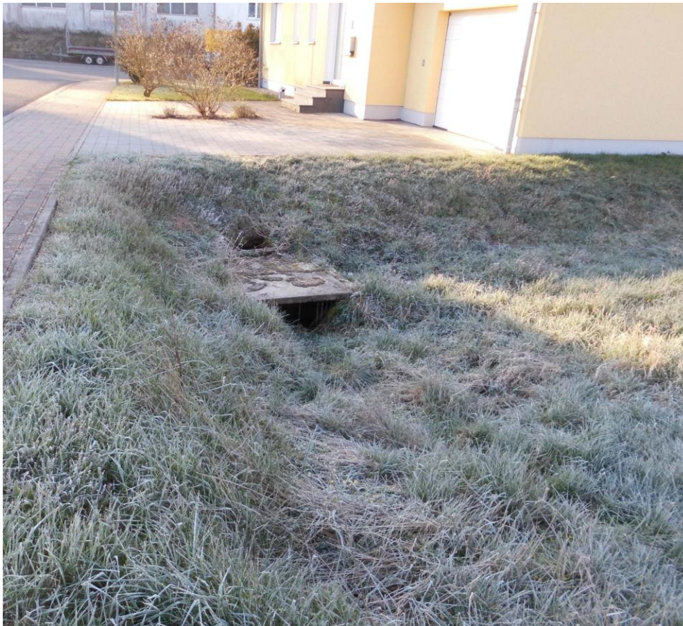
Abbildung: Einlaufbauwerk für das Einzugsgebiet „Im Weiher“
