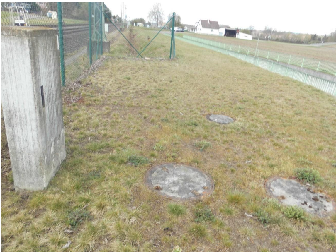
Abbildung: Pumpstation mit Auslaufgraben
