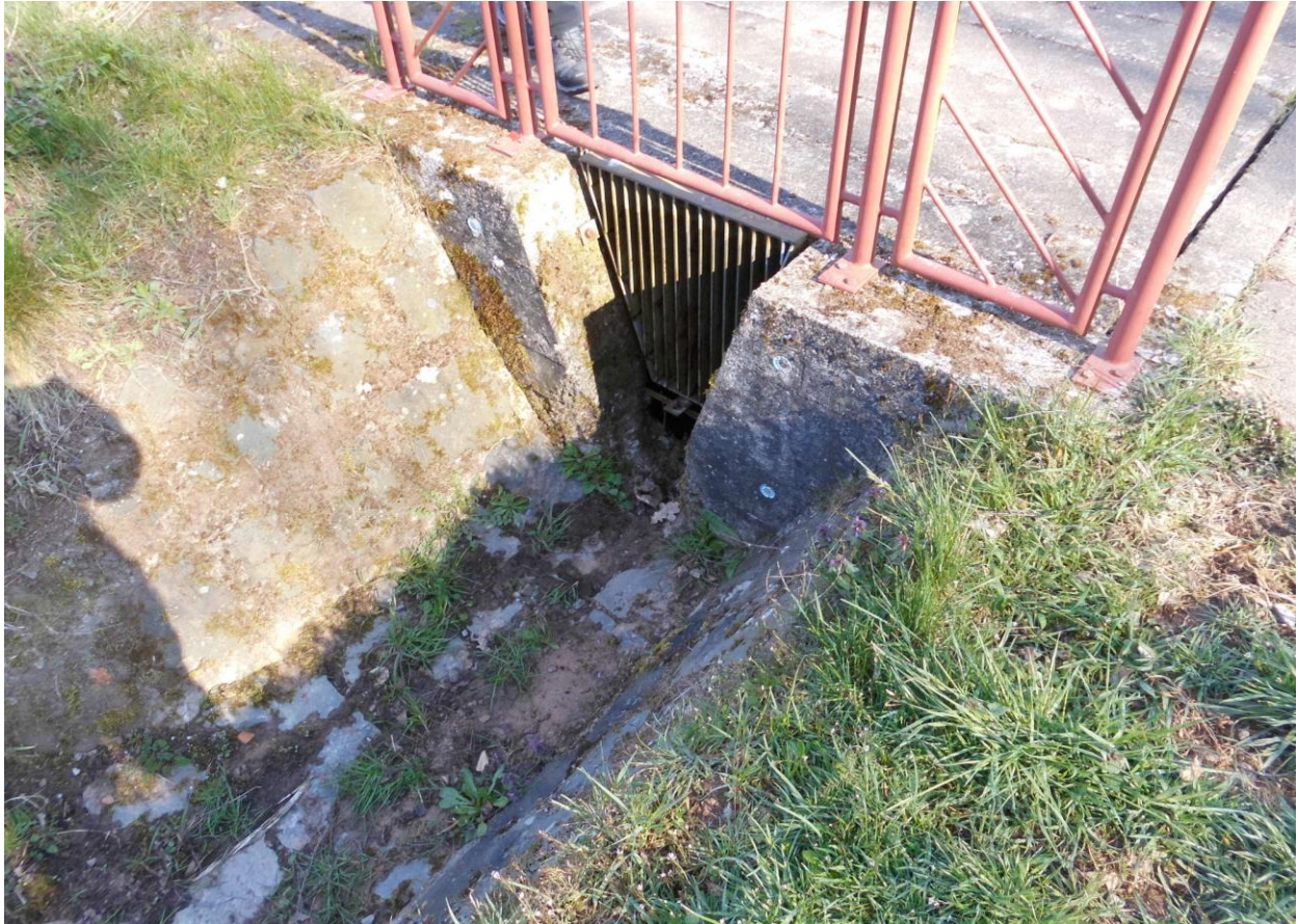
Abbildung: Stark eingengter Einlauf mit Gitter – Einlaufbauwerk nicht überströmbar
