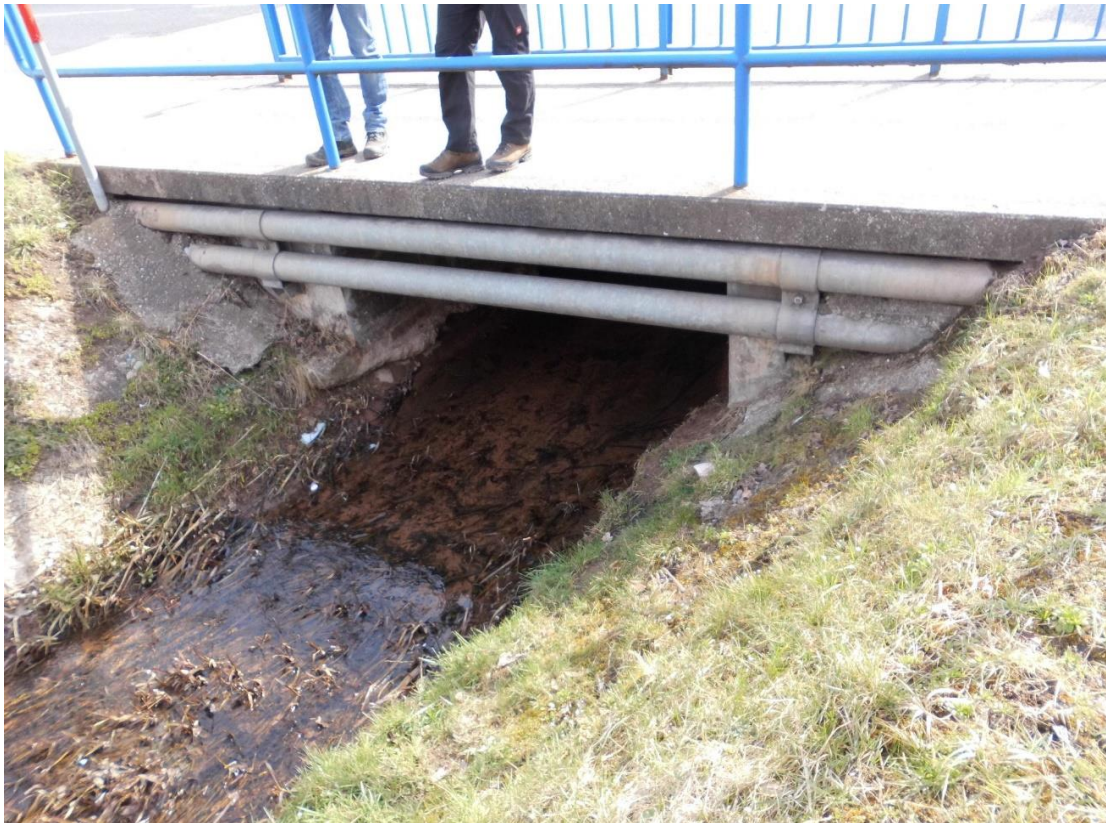
Abbildung: Mühlbach, Brücke Kaiserstraße, Querschnittsverengung durch Versorgungsleitungen
