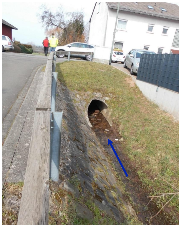
Abbildung: Querung der Straße „In den Betzen“ mittels Rohrdurchlass
