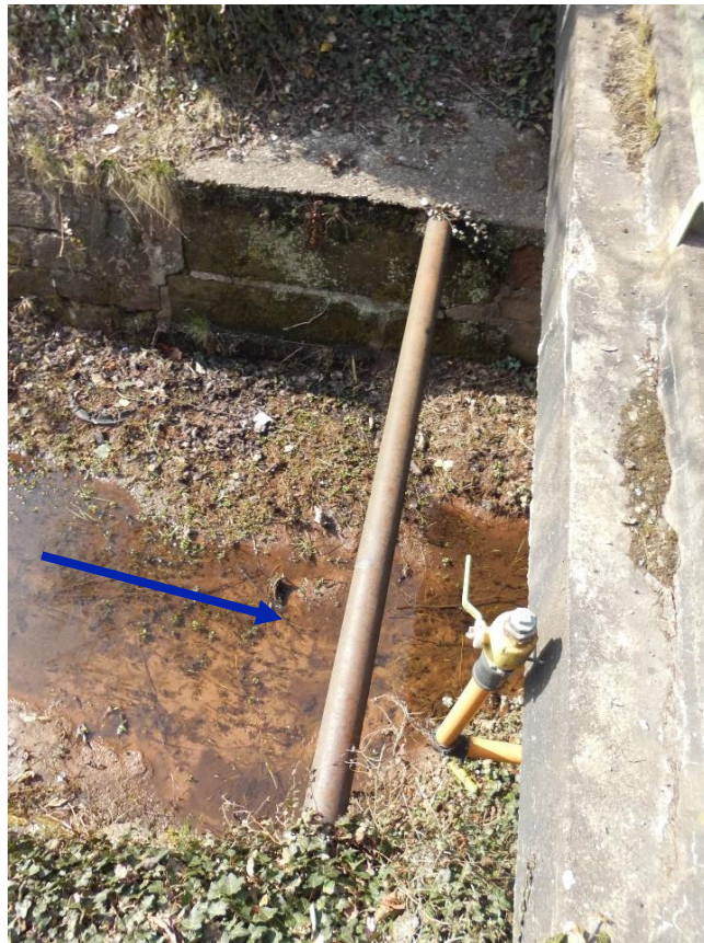
Abbildung: Reduzierung des Abflussquerschnitts durch Versorgungsleitungen
