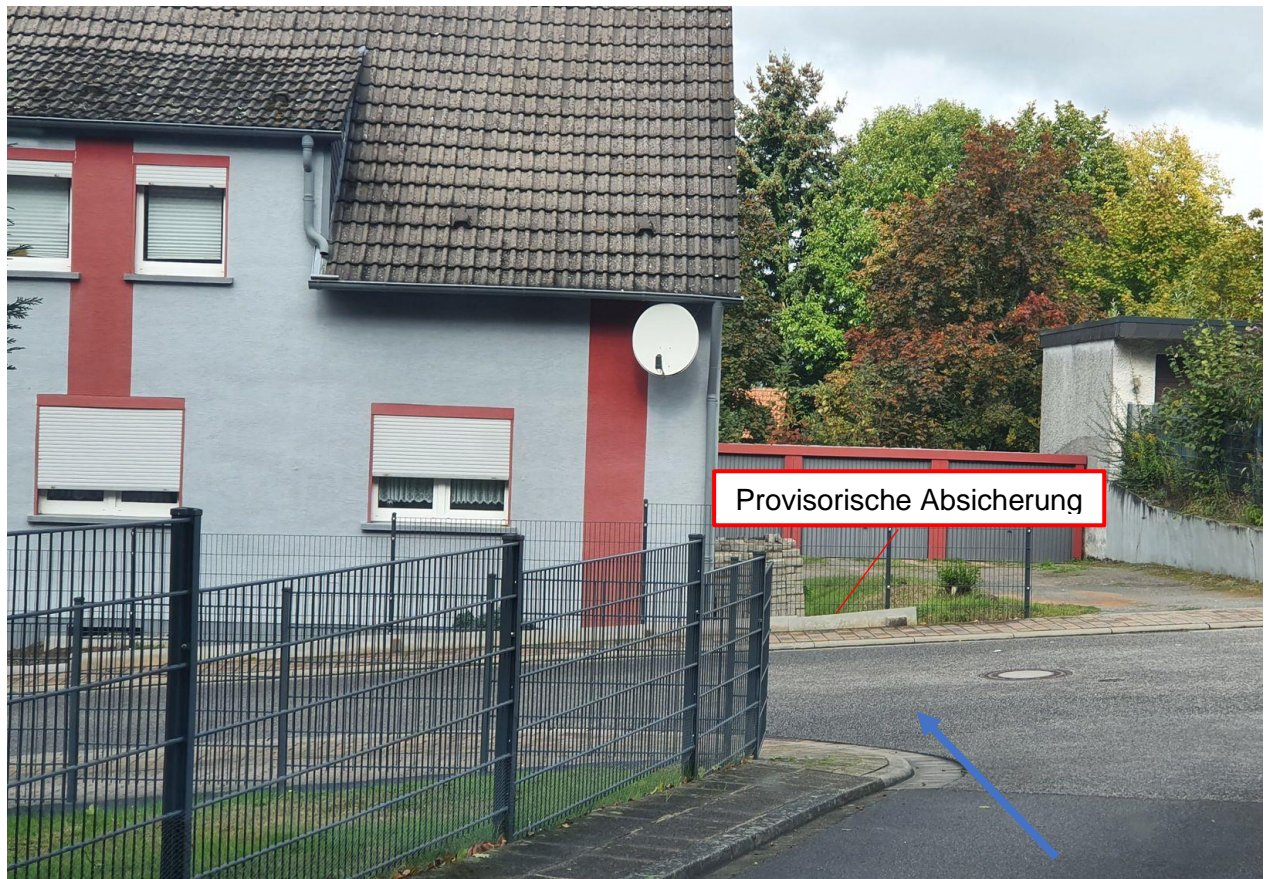
Abbildung: Betroffenes Anwesen in der Steinstraße, provisorische Absicherung
