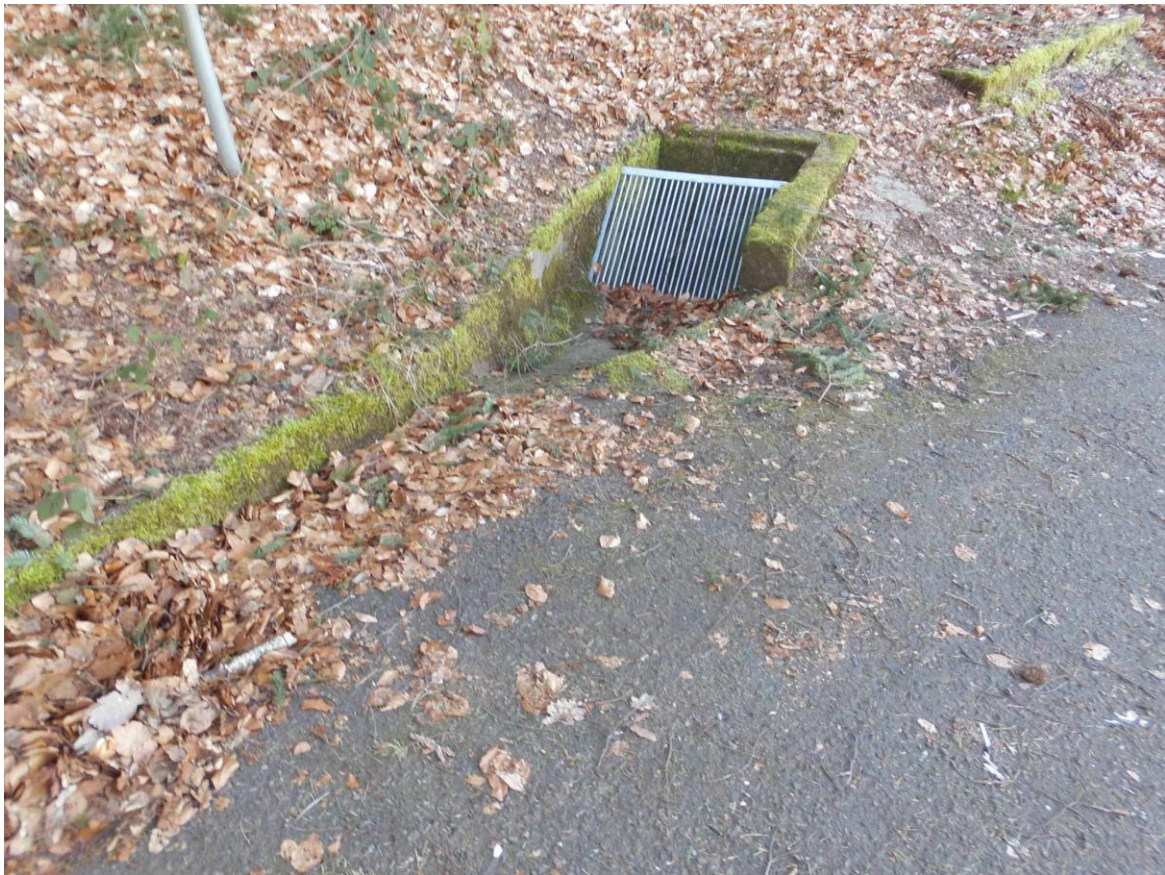
Abbildung: Vorh. Einlauf unterer Rotherweg
