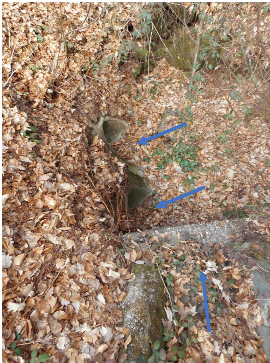
Abbildung: Rohreinläufe im Bereich der Landstraße L466 sowie Zulauf der Straßenentwässerung
