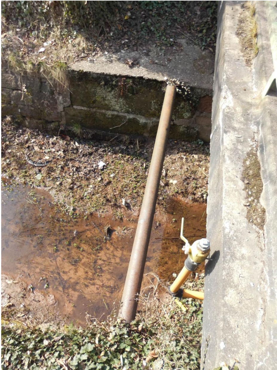
Abbildung: Frohnbach Überfahrt „Kaiserstraße“ – Fremdleitungen im Abflussquerschnitt
