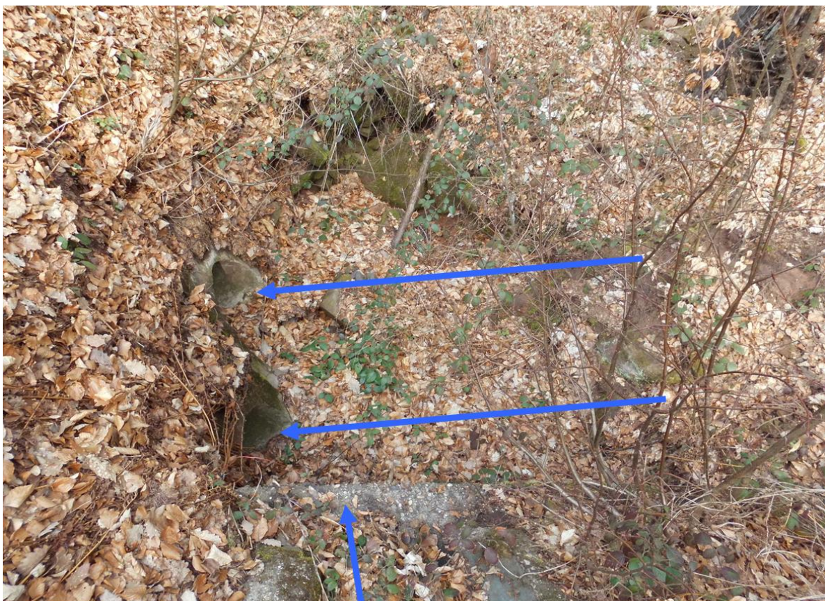
Abbildung: L466 - 2 Rohrdurchlässe und Straßenentwässerung
