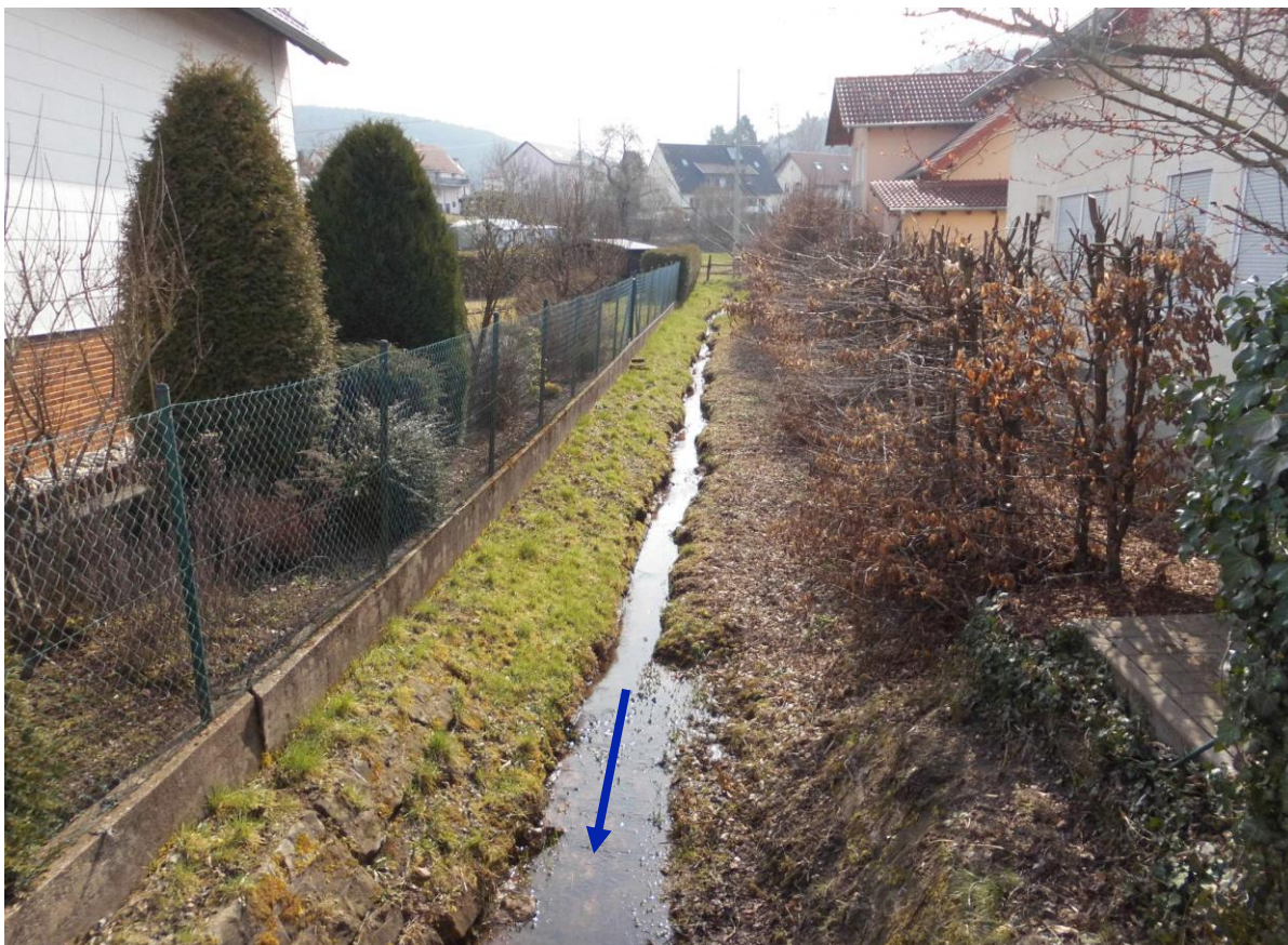
Abbildung: Frohnbach, eingengtes Abflussprofil
