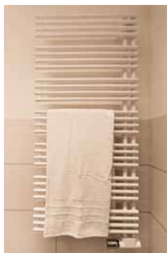
74 Handtuchheizung mit höher montiertem Ventil
