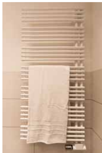
74 Handtuchheizung mit höher montiertem Ventil
